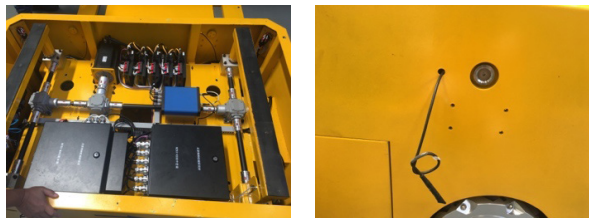
(a) AGV 车集成的 iGPS 信号处理器和接收器
